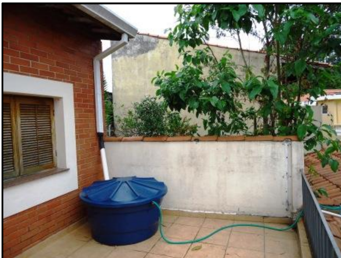
Uma outra instalação para acumulação e uso de águas de chuva incidentes sobre telhados
