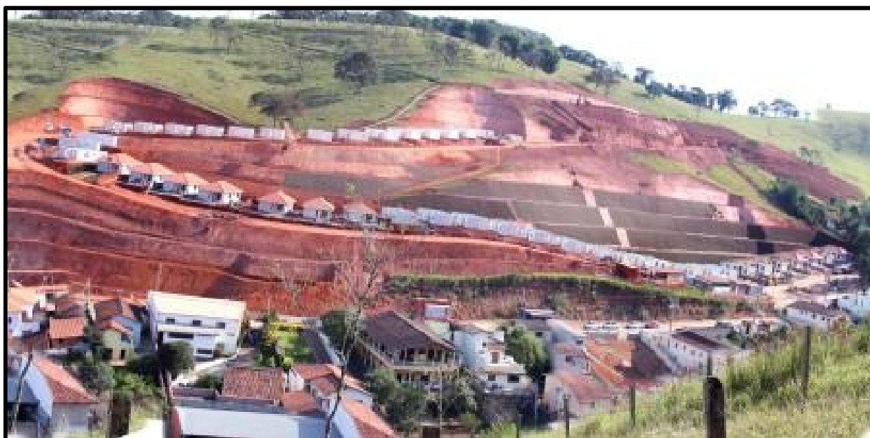
Exemplo de adoção de concepção (produção de patamares planos via operação de terraplenagem) totalmente inadequada a terrenos de média e alta declividade
