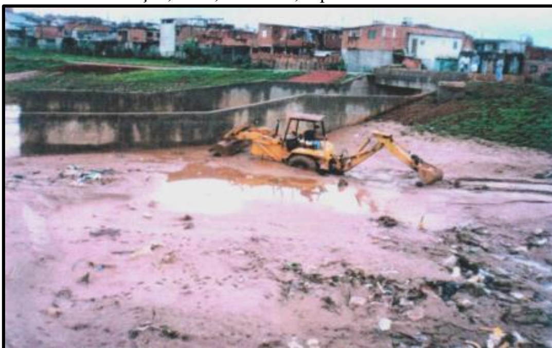
Piscinão totalmente assoreado de sedimentos, lixo urbano e entulho de construção civil
