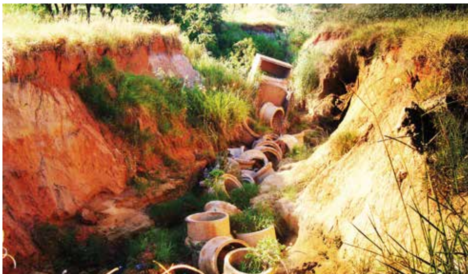
Idem. Colapso geral e erosão remontante ativada por sistemas de drenagem mal concebidos e executados. São José do Rio Preto (SP). Foto: G. Salviano
