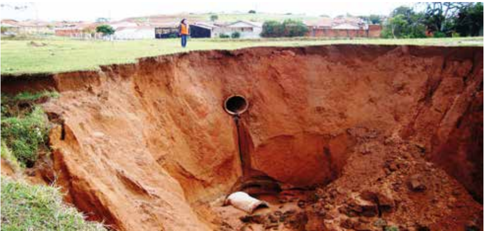
Processos erosivos remnantes decorrentes do descuido técnico na condução de águas pluviais e servidas para o exterior de zonas urbanas periféricas assentadas sobre terrenos de alta suscetibilidade à erosão. Botucatu (SP). Foto: G. Salviano
